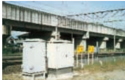
踏切メモリーが入っている「踏切ボックス」
